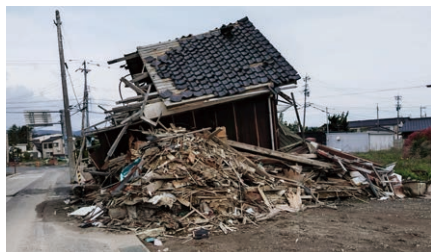
残されたままの被災家屋
